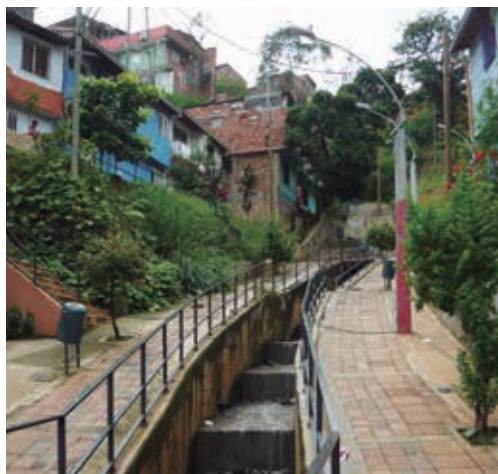
La infraestructura de drenaje mejora en gran medida las condiciones de áreas inclinadas en Medellín, Colombia © ONU-Habitat/Laura Petrella
